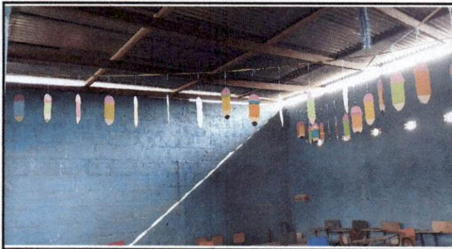
Foto 3: Techo de aula de primero C en mal estado a intervenir
